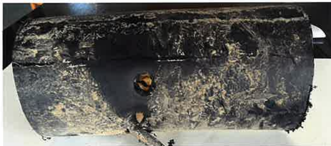
Hullet i fjernvarmerøret er forårsaget af et lyslederkabel
